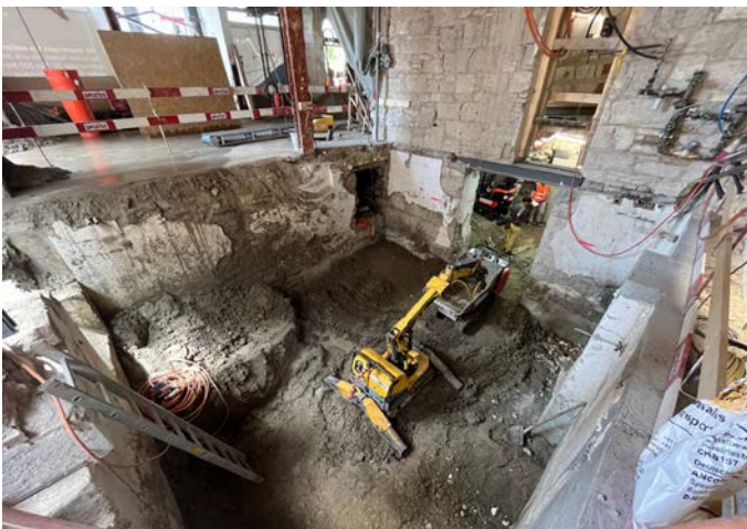
Von Januar bis August 2022 wurde das achtgeschossige Gebäude vom Unter- bis zum Dachgeschoss bis auf die rund 200jährige Rohbaubsubstanz entkernt. (Foto: zvg)
